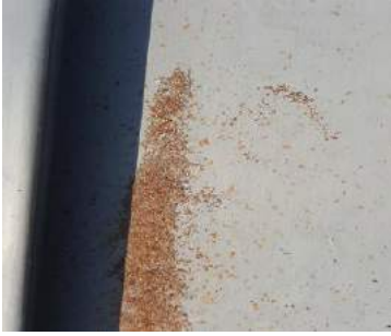
Yakındaki demir kesimi sonucunda; demir çapakları çinko yüzeyinde korozyon oluşturmuş.
