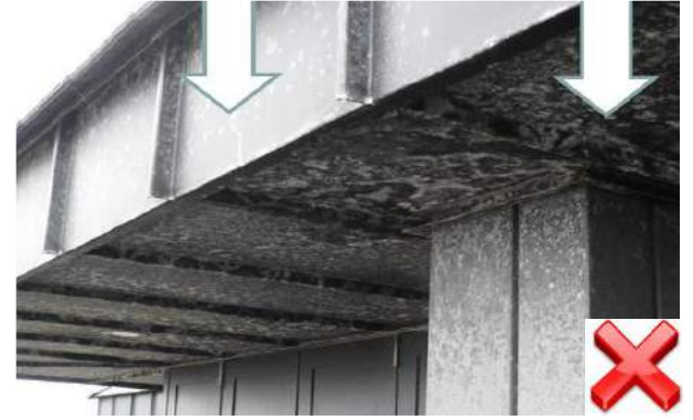
Yağmur suyu ile yıkanamayan ters tavan örneği
