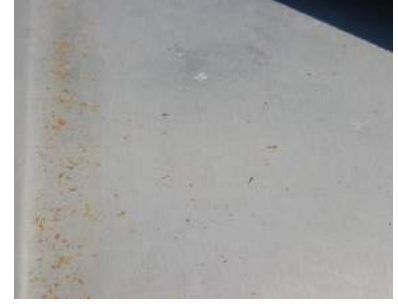
Yoğun pas bol su ile yıkanarak uzaklaştırılmış, kalan paslı bölgeler doğal patina oluşumu sayesinde zaman içerisinde temizlenecektir.
