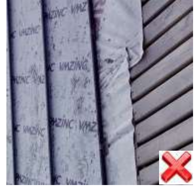
Örtü, havalandırma kesitini engelliyor.
