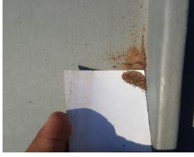
Yakındaki demir kesimi sonucunda; demir çapakları çinko yüzeyinde korozyon oluşturmuş.
